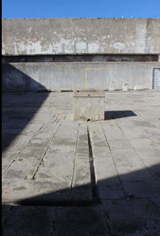
Canal de recolha das águas pluviais
